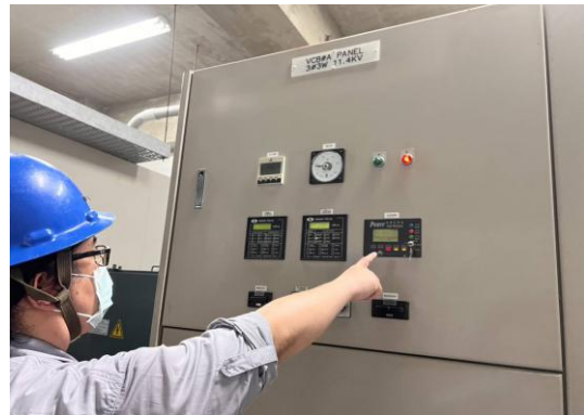
《J 棟自動復閉器汰換後現況》
