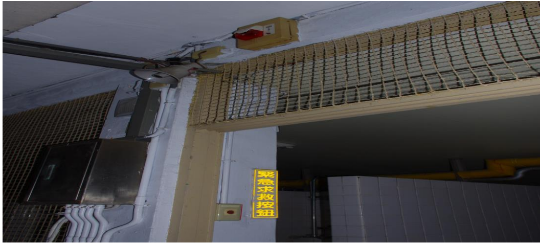
女生宿舍(監視器及警報器)
