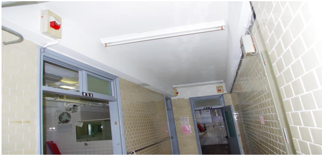
女生宿舍(監視器及警報器)
